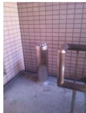
喫煙スペース (非常階段)
